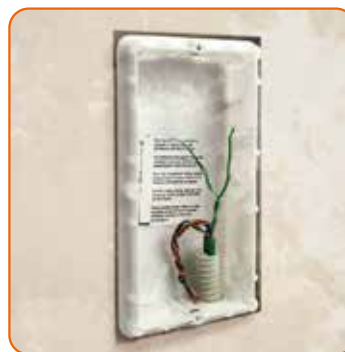
Utilisation d'une paire de fils existante pour connecter le nouveau poste extérieur 2 fils
